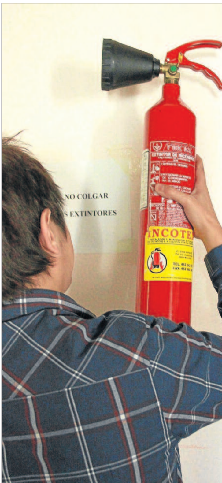
Los equipos contra incendios deben revisarse anualmente. AZAEL FLORES
